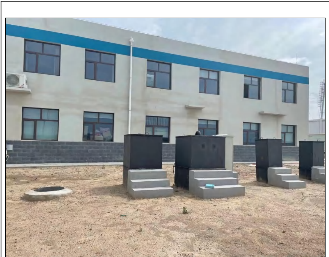
图4-4 项目污水处理设施
