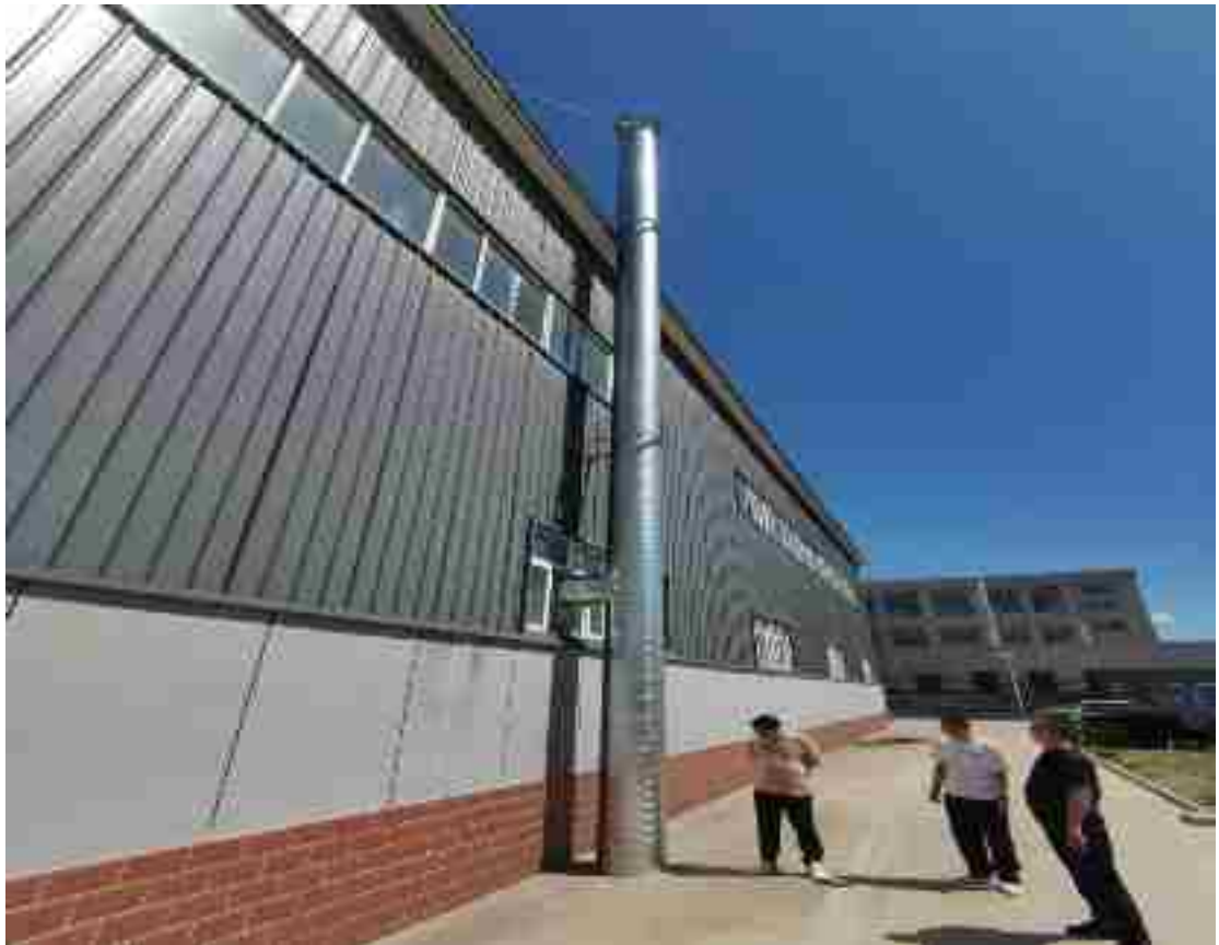
图 3-4 本项目 15 米排气筒照片
