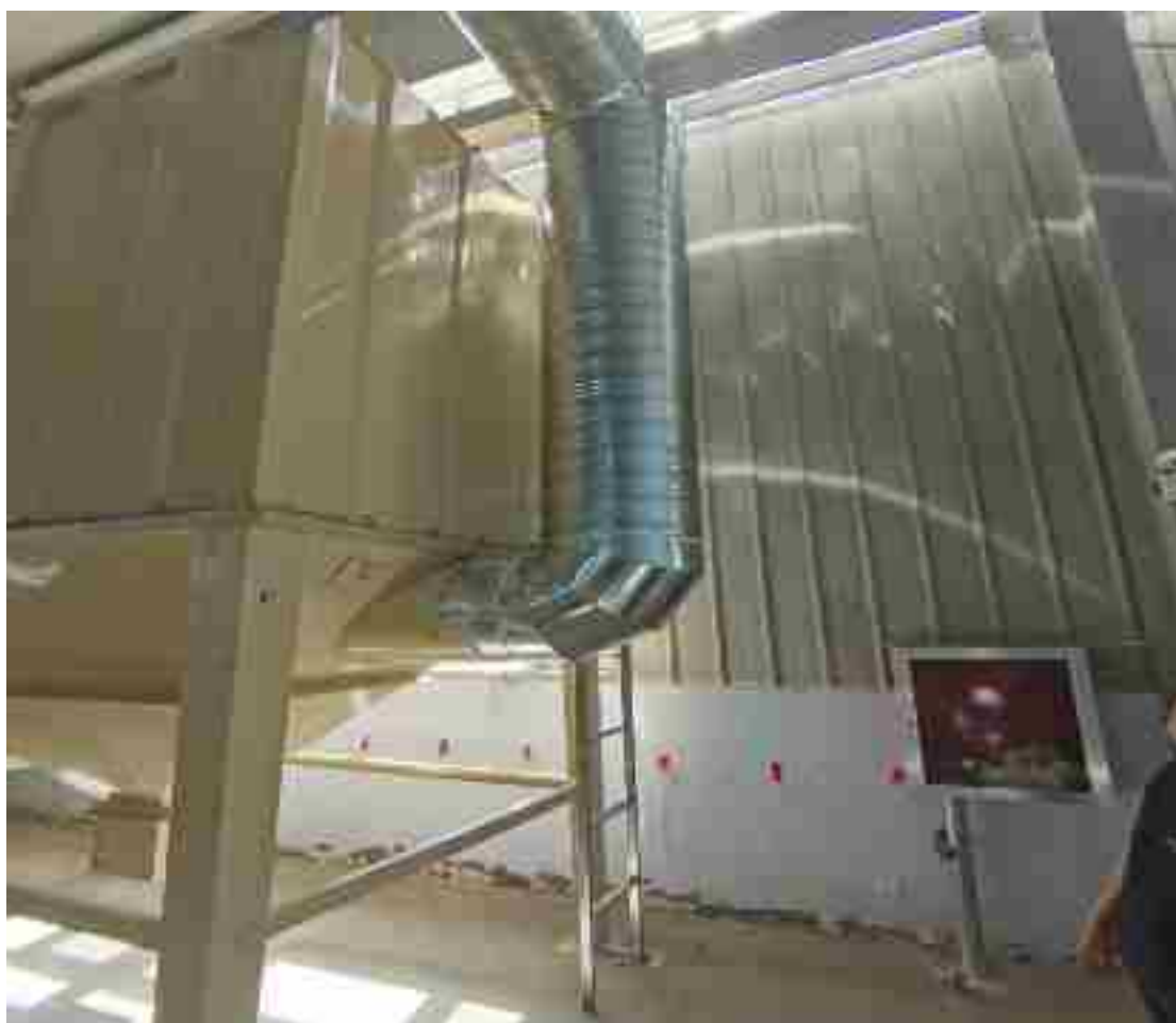
图 3-2 本项目布袋除尘器照片
